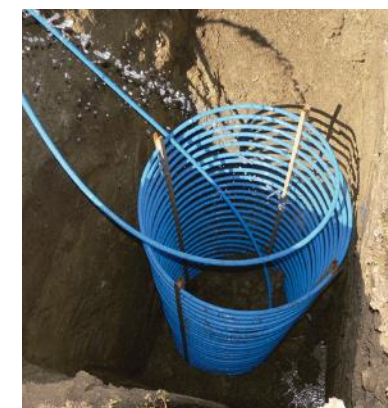
avec des échangeurs compacts
