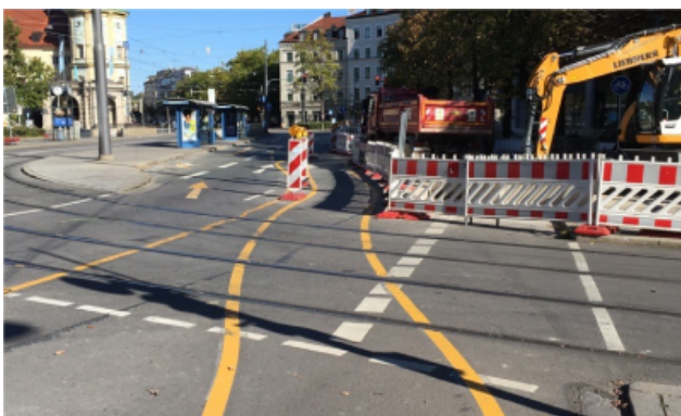
Lors d'un chantier routier à Stiglmaierplatz à Munich, une piste cyclable temporaire est aménagée, marquée clairement au sol et séparée avec des aménagements temporaires du trafic motorisé
