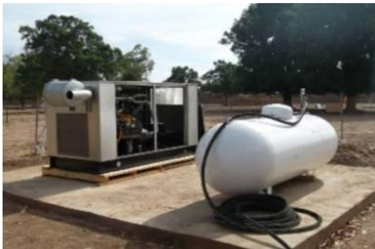
Production d'électricité par Hydrogène Naturel au Mali sur le site pilote de Bourakébougou (1 ère mondiale) , source Hydroma inc
